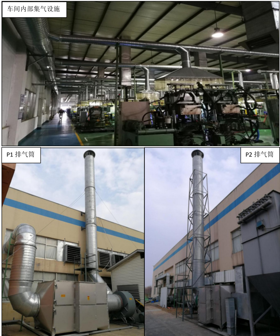
图 4-3 废气处理设施现状图
