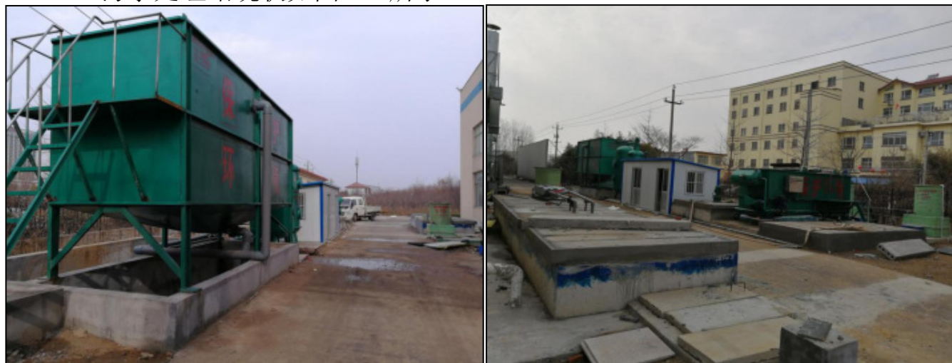
图 4-2 污水处理站现状图（左为生产废水处理设施，右为生活污水处理设施）
